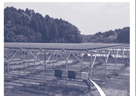
発電所の下には、6月頃大豆が植えられる予定です。
